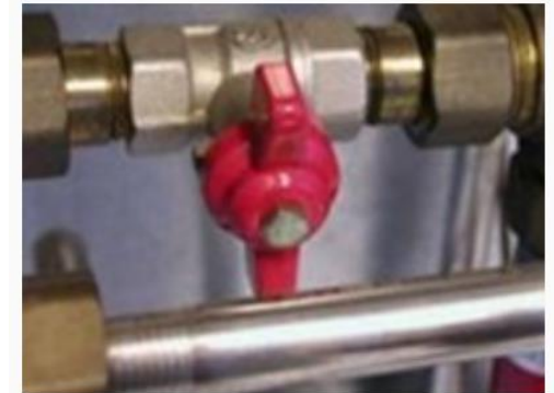
Sommerventil lukket Cirkulationspumpe stoppet
