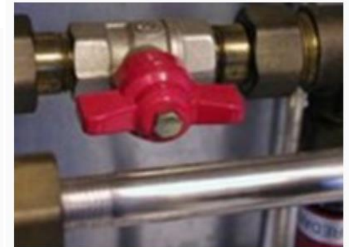
Sommerventil åben Cirkulationspumpe i drift
